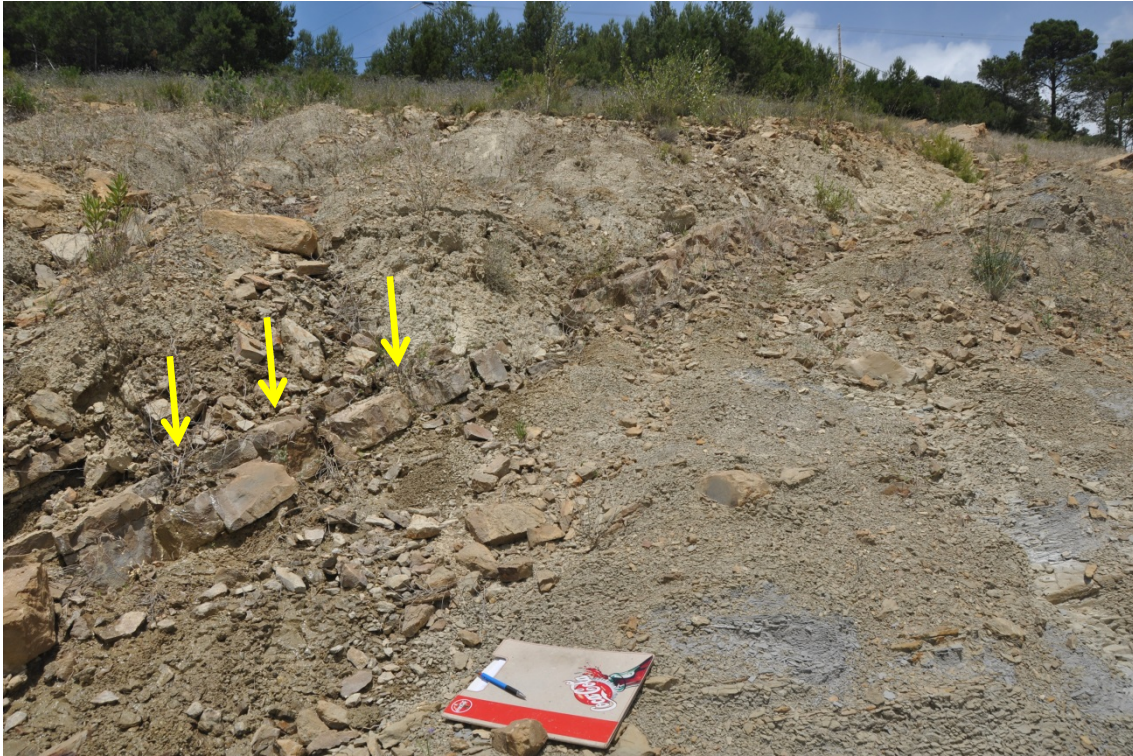
Figura 19. Rezumes (flechas amarillas) en el contacto entre las areniscas y arcillitas del flysch de Yesa, en los desmontes de la antigua N-240. Nótese el aspecto húmedo del suelo
