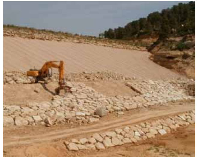
Obras de emergencia para la reparación de la presa de Valcomuna (Teruel).
