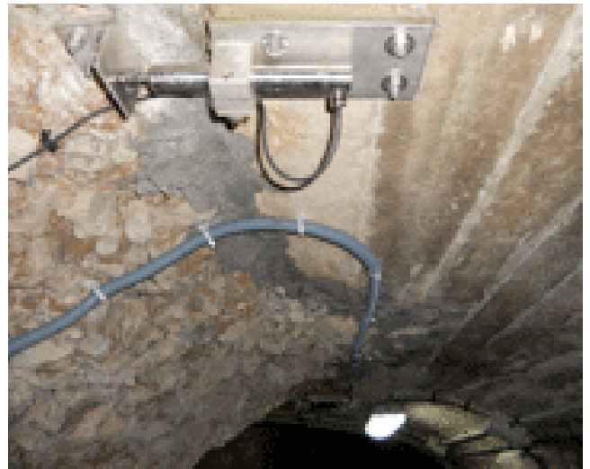
Presa de Mediano: Nuevo medidor de juntas instalado en la presa, sensor tipo LVDT.
