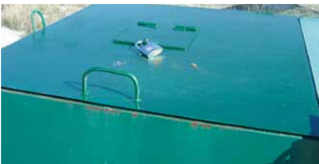
Red piezométrica. Adecuación tapa arqueta para mejor medición de niveles
