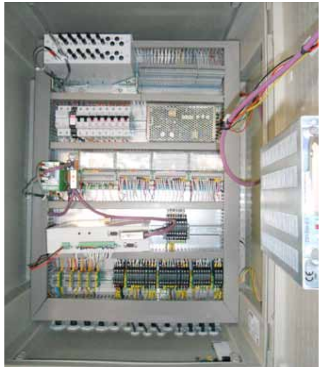
Presa de Las Torcas: Armario de centralización de lectura de los instrumentos de auscultación.
