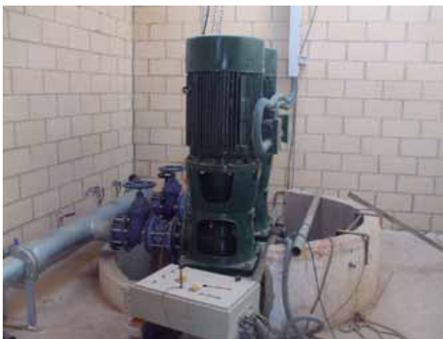
Pozo de abastecimiento a Sartaguda, Navarra.
