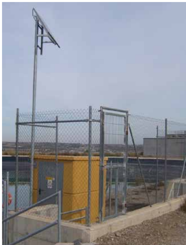
Optimización de la gestión de los recursos hídricos del Canal de Aragón y Cataluña mediante telecontrol.
